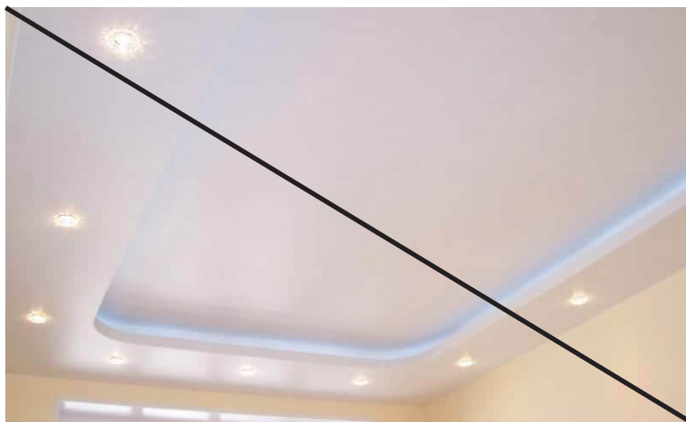
Плохо Многоуровневые гипсокартонные конструкции
