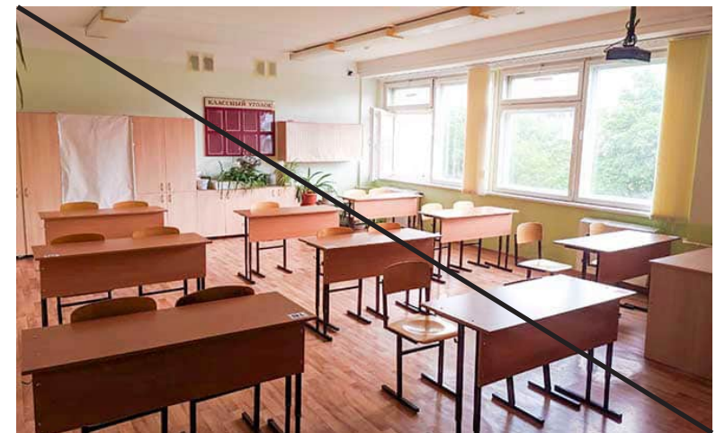
Плохо Линолеум под дерево
