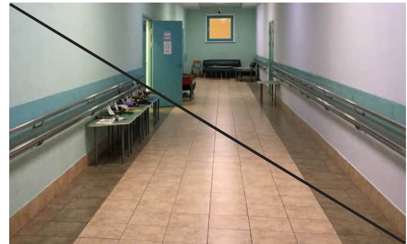
Плохо Керамогранитная плитка с крупными швами
